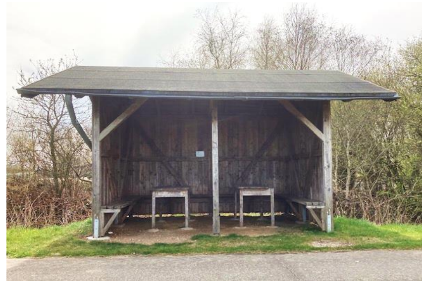
Schutzhütten mit Sitzmöglichkeiten, wie hier am Erfder Damm bei der Steinschleuse, bieten dem Gast Schutz vor Wind und Wetter. Auch das Mobiliar bleibt trocken und hält so länger.
